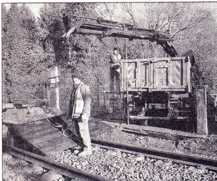
Le démontage du quai de la halte de la Ferrière tourne une page de l'histoire du village / Photo Valerie Poncet
